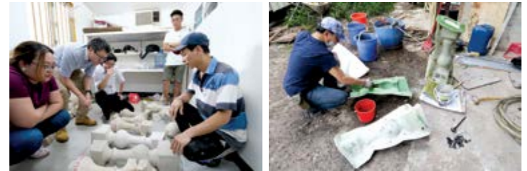
圖15 為確保欄杆柱在外觀、物料、顏色、質感及工藝方面與原來欄杆柱一致，項目團隊檢查和監督新水泥欄杆柱的製作。
